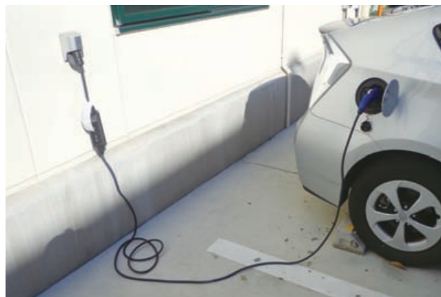
EV充電設備
